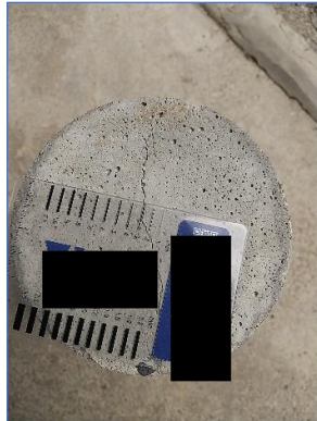
T-⑤ひび割れ幅0.3mm
